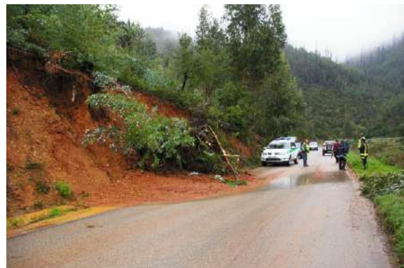
Figura 5.10 – Deslizamento de vertente
