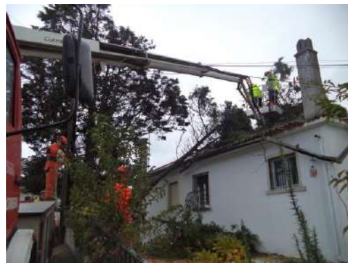
Figura 5.13 – Tempestade Ana em 2017- queda de infraestruturas de fornecimento de energia elétrica
